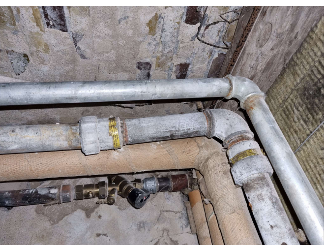
En blanding af forskellige rørtyper i kælderen.
