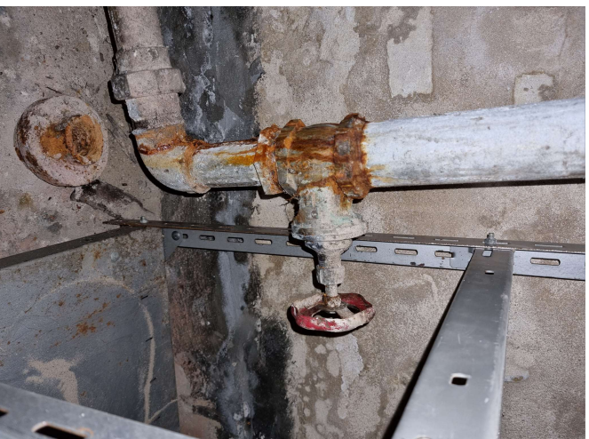
Tegn på utætheder ved samlinger af rør.
