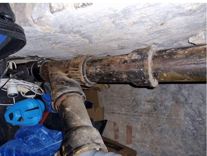
Eksisterende faldstamme i støbejern – med tegn på utætheder.
