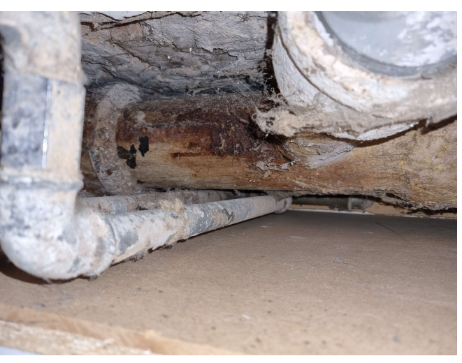
Eksisterende ældre faldstamme i støbejern i lejlighed med utæthed langs forgrening.
